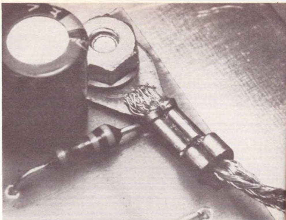
Photo 2. – Cette cosse de masse mal serrée vient toucher une patte de résistance.
