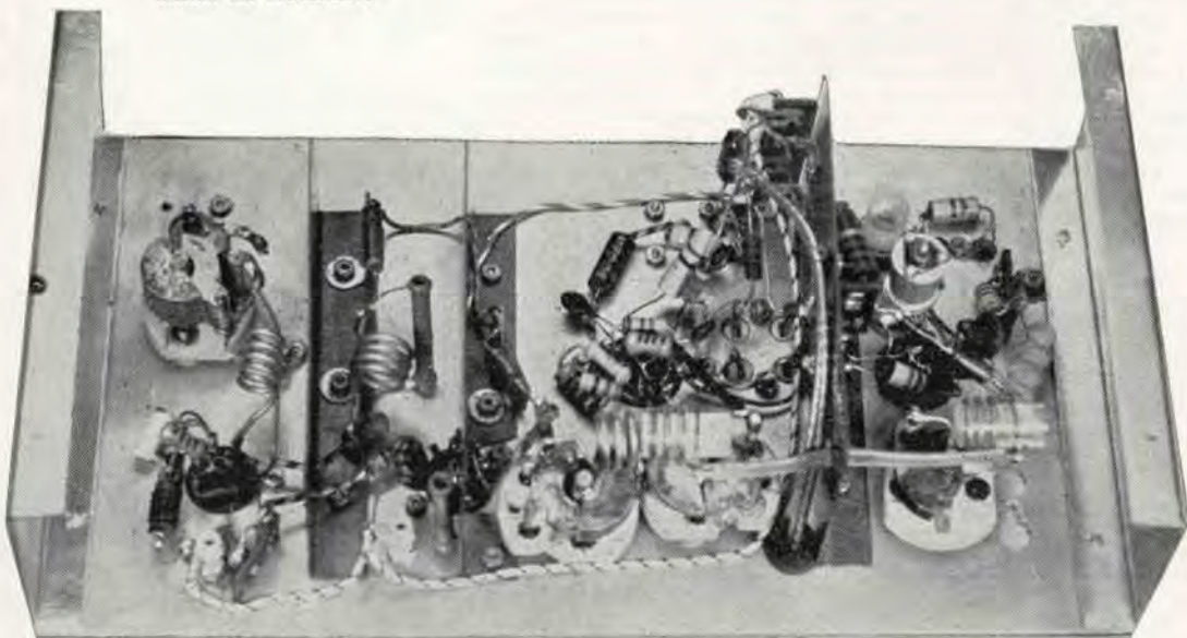
Interno del convertitore
