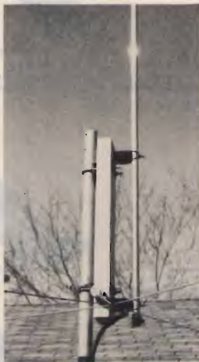
La base dell'antenna, con i radiali e la linea di alimentazione bicoassiale.
