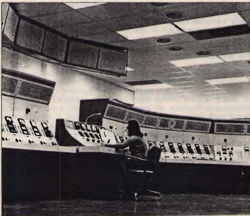
foto 1 La sala di controllo del centro di Kavala usato congiuntamente da Radio greca e VoA.
