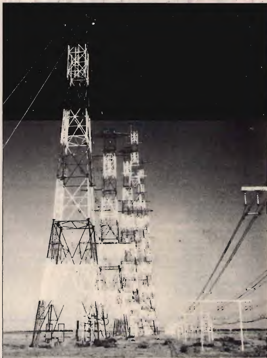
Antenne di R.E.E. a Noblejas (Madrid): disposte in tre serie a 120°, ciascuna come nella foto, consentono la copertura radiale totale (foto REE/LC).
