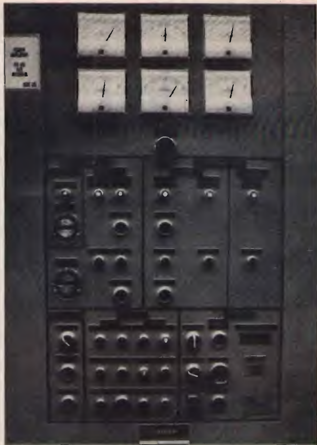
Il pannello di controllo dell'amplificatore di potenza.
