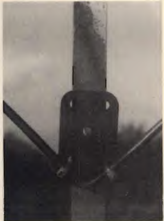
Un isolatore di fortuna.
