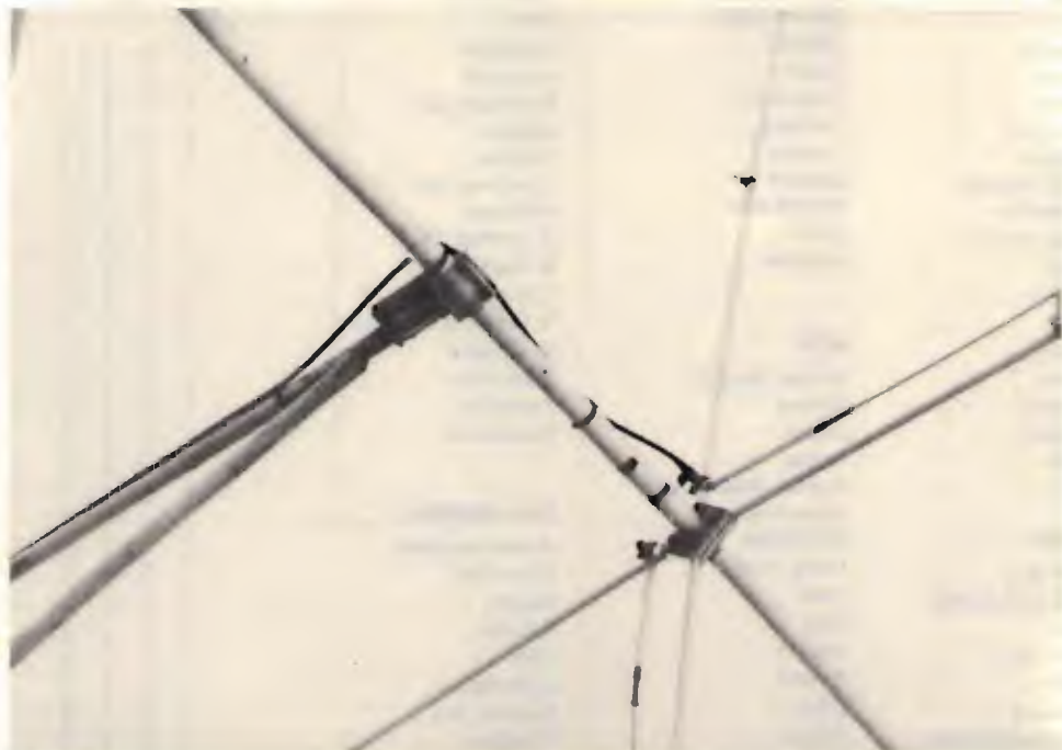
Particolare dell'attacco del cavo RG11 al bocchettone della polarizzazione orizzontale.
