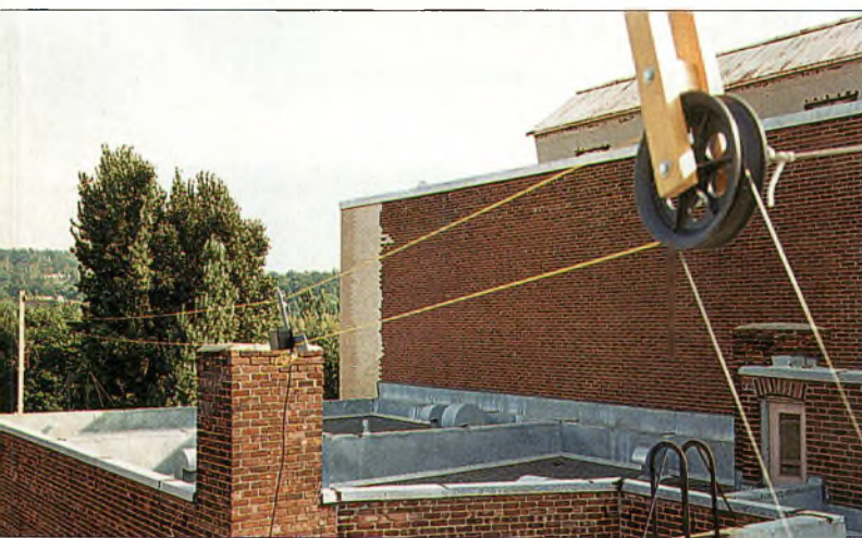
Photo 7 - Tout le tremblement ! Notez que les fils sont parfaitement parallèles. Ils sont maintenus en partageant le poids de la ligne d'alimentation entre le fil du haut et celui du bas ainsi que par les charnières de tension variable à chaque extrémité.
