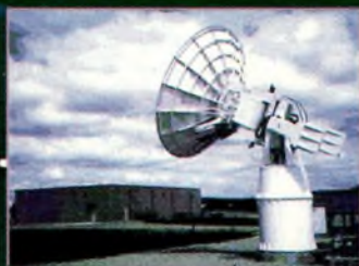
Les antennes d'une station-passerelle.
