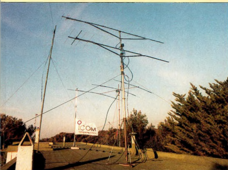
Vue sur les antennes.
