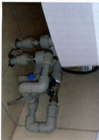
Obr. 1. Přemostění přetlakovému ventilu uzavíracím ventilem
