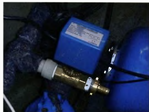
Obr. 3. Elektroventil je zapojen paralelně k vypouštěcímu ventilu ve vstrojení studny
