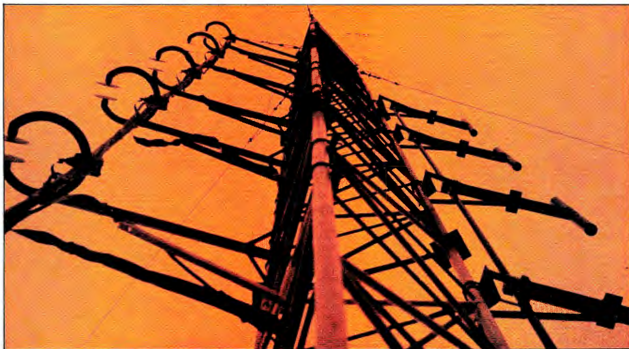
Actual installation, WGMS-FM
