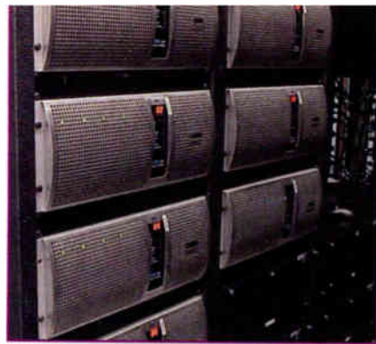
The Klotz VADIS 880 mainframe
