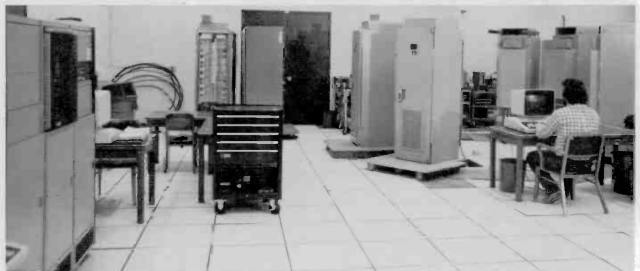
Fig. 8. Subelement test system.
