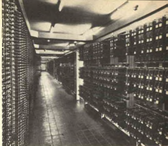
Fig. 4 - Tipica sala di relé impiegante un'attrezzatura che è stata realizzata dalla AEI - General Signal.
