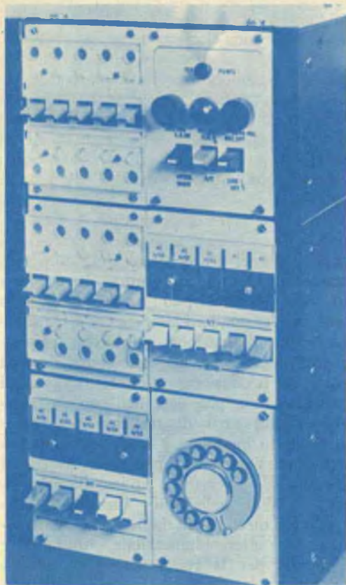
Tipica installazione di un controllo di comunicazioni Minicom della Plessey Radar Company.
