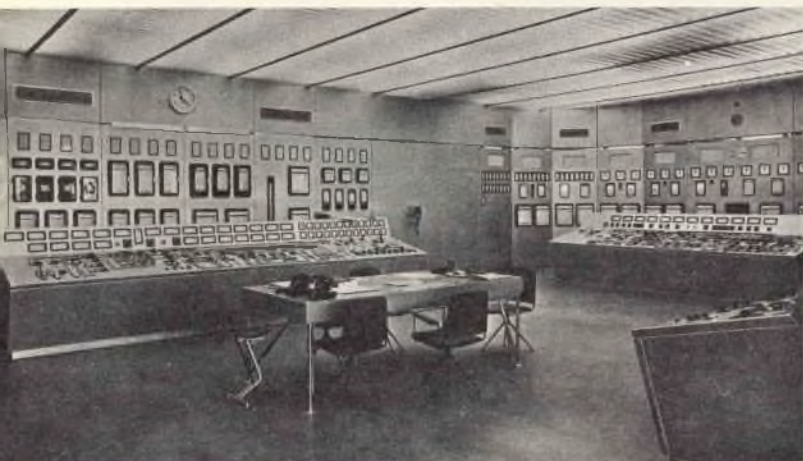
Nella sala quadri della centrale di Chivasso, i quadri di misura sono del tipo ad intelaiatura verticale e, come è ben visibile, riportano solo strumenti di misura. Sui quadri di manovra, del tipo a leggìo, sono riportati gli schemi ripetitori automatici.
