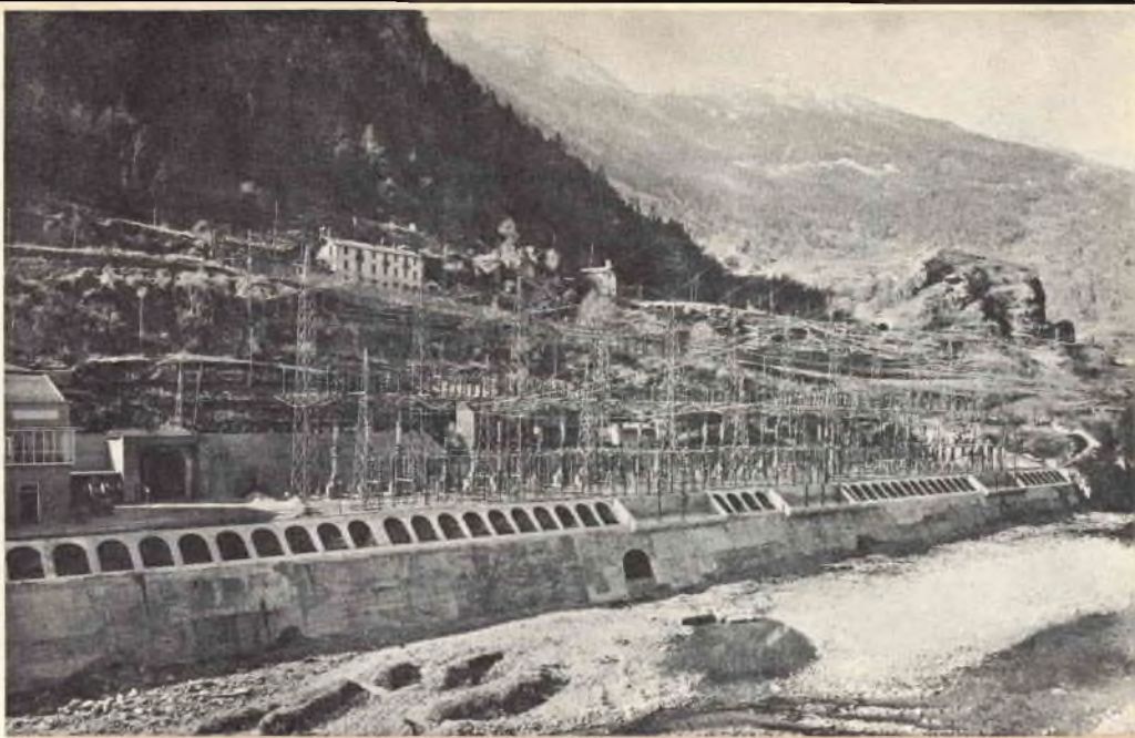
L'impianto di Avise della SIP rappresenta un esempio di installazione in cui le apparecchiature di manovra quali, interruttori, sezionatori ed i relativi sistemi di sbarre sono sistemate all'aperto.
