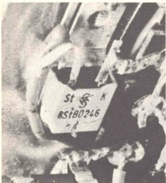
Nella realizzazione del primo esemplare lo SCR, al centro dell'immagine, è stato fissato al contenitore.
