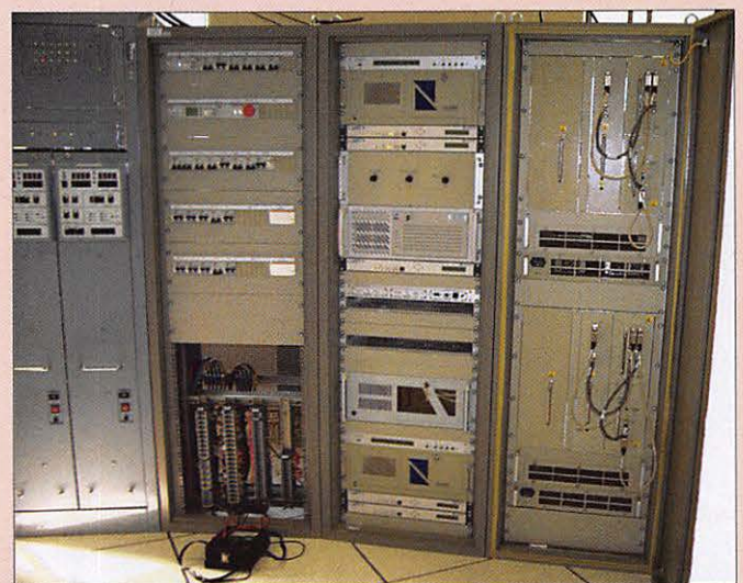
5 - À g. les deux baies de l'ancien radar secondaire mono-impulsion de Montpellier, et à d. le nouveau, Mode S, "CIRIUS" fabriqué par Thalès.
