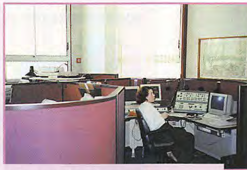
Les postes des opérateurs phonies
