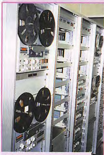
Station automatique RTTY (Sitor). Les trous correspondent aux appareils retirés après diminution du service.
