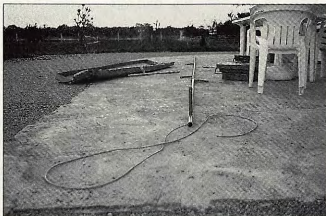
Début de l'assemblage. On voit la sortie du coaxial par le bas du tube.
