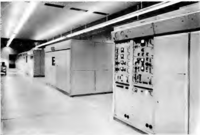
Bild 1. Blick in die Senderhalle des DLF-Mittelwellensenders Neumünster. Rechts: 300-kW-Sender 1 mit Steuersender und Überwachungsgestell, in der Mitte das Parallelschaltnetzwerk, im Hintergrund Sender 2
