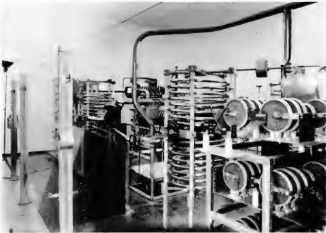
Bild 2. Die Antennenabstimmittel im Antennenhaus 1
