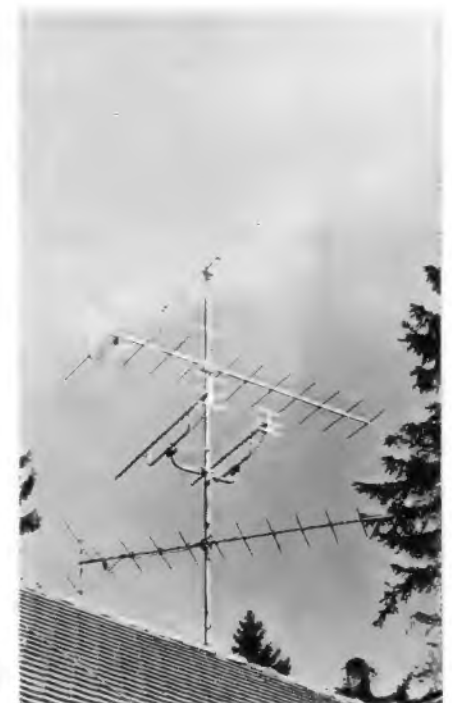
Bild 4. Überdach-Antennenanlage für den Empfang von Sendern in den Bereichen II (UKW), III, IV und V
