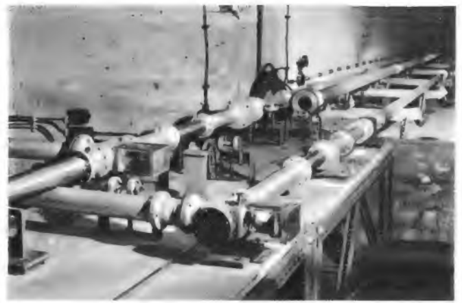
Bild 14. Unterirdischer Meßraum und Anfang eines 300 m langen Kanals mit darin verlegten Hohlkabeln
