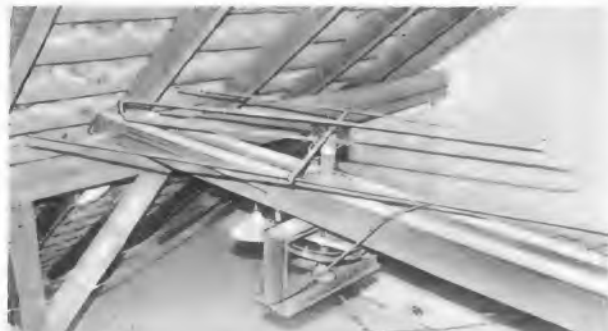
Bild 1. Die drehbare Richtantenne auf dem Dachboden. Hinten an der Wand das Gegengewicht mit dem Ziegelstein. Auch die Antenne wurde - wie im Text erwähnt - selbst gebaut, um die Kosten so gering wie möglich zu halten
