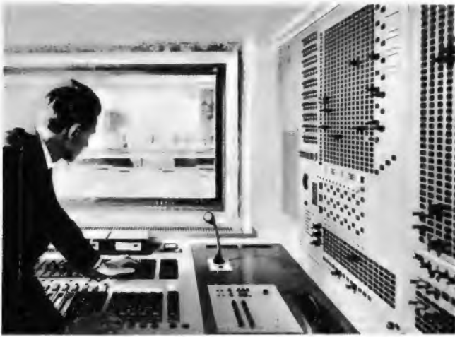
Bild 3. Teilansicht der Ela-Loge, von der aus Effekte in die Aufführung eingeleitet werden können. Durch die Glaswand ist der Blick auf den Zuschauerraum und die Bühne frei. Links vom Mischpult befinden sich die Tonbandmaschinen und die Plattenspieler
