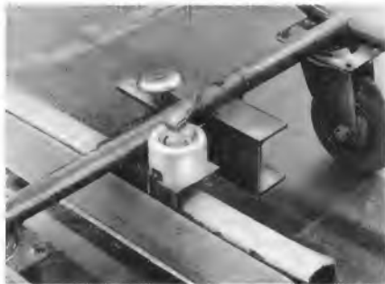
Bild 1. Stromführungsschiene und Unterteil eines Transportwagens mit Steckdose in der Nähe des Schleifkontakts
