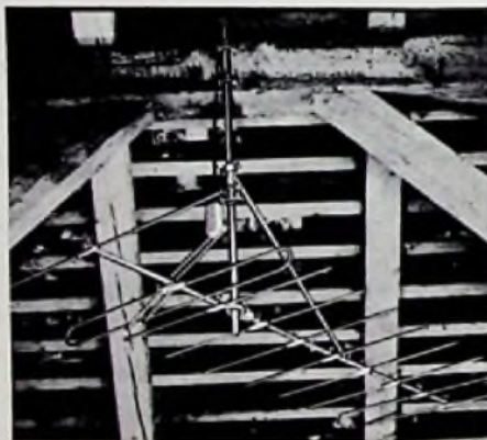
Fernseh-Antenne mit zehn Elementen, an einem Dachbalken hängend montiert (Kathrein Maxima 1)
