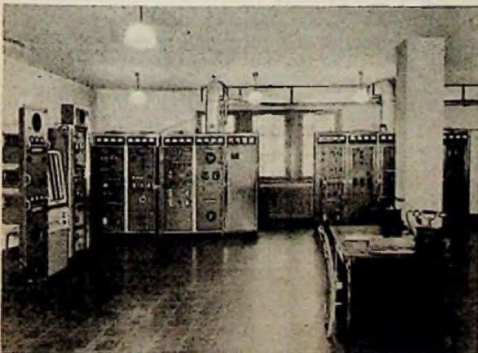
UKW-Senderaum: links Ball-Empfangsgestelle, daneben zwei 10-kW-UKW-Sender (Rohde & Schwarz). Der Fernsehsender der Bundespost steht rechts davon (auf dem Bild nicht sichtbar)
