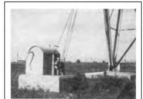
Eine Winde dient dazu, die Strahlwerferantenne zur Reparatur oder zwecks Abänderungen herabzulassen.
