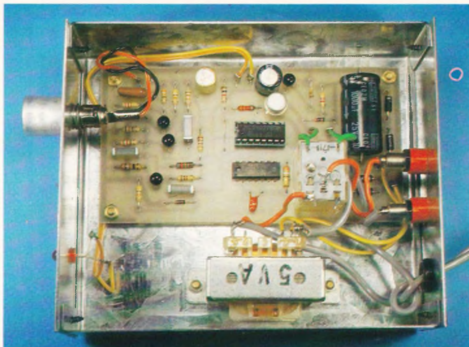
Photo 4. – Vue de l'ensemble (intérieur du coffret).
