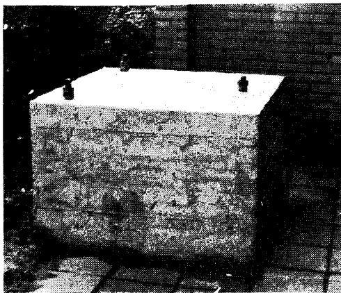
Foto 2. De fundatie is gereed. De grondplaat is afgedekt met een laag aarde en daarop weer de tijdelijk weggenomen tegels van het plaatsje.
