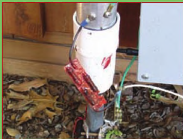
Foto B. Tres resistencias de 3 M en serie montadas en una placa preperforada en la base de la antena vertical de 13 metros del autor.
