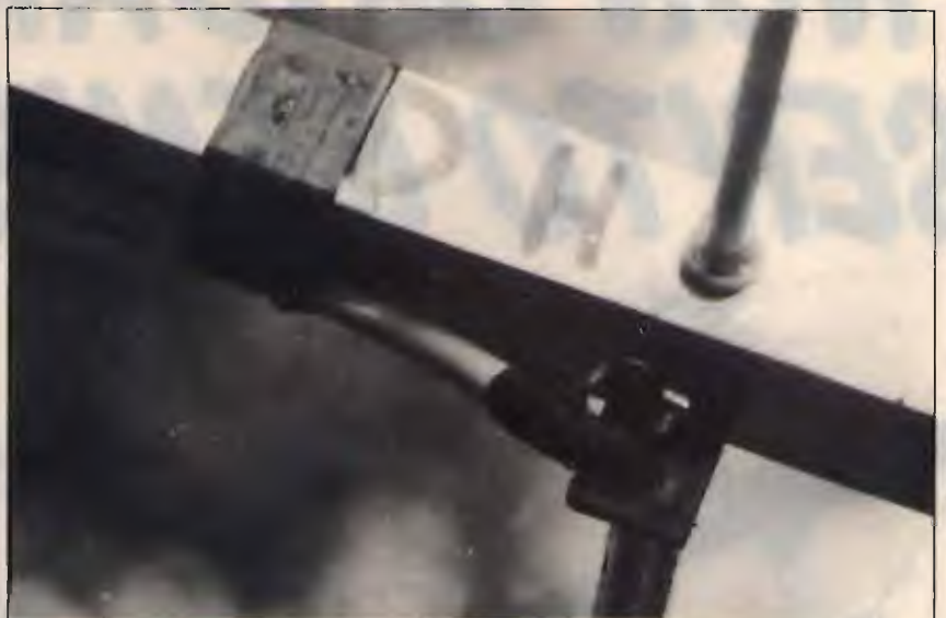
foto 6 Particolare del collegamento cavo-condensatore gamma-match.
