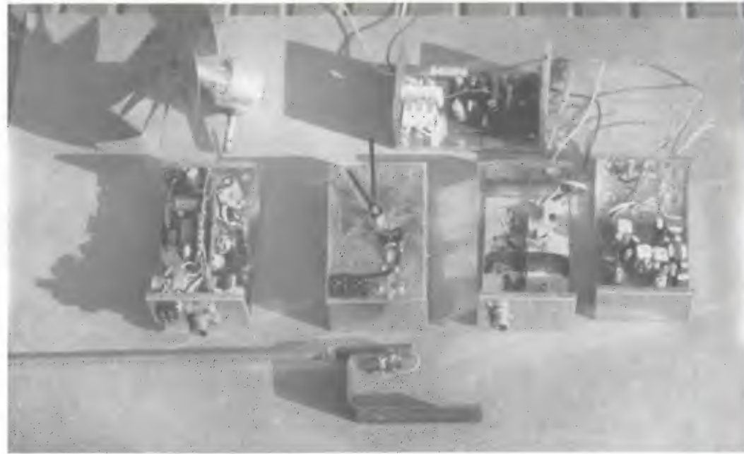
Vista d'insieme di tutte le apparecchiature costituenti il repeater.
