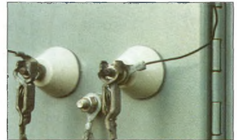
La mise à la terre est assurée par des pinces accrochées directement en sorties des isolateurs.
