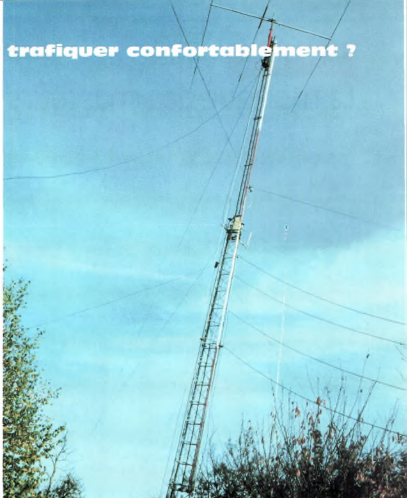
Comme les plantes, les antennes ont besoin de hauteur et de dégagement pour s'exprimer pleinement.
