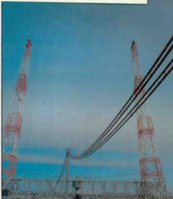
More antennas at Santa Maria di Galeria.
