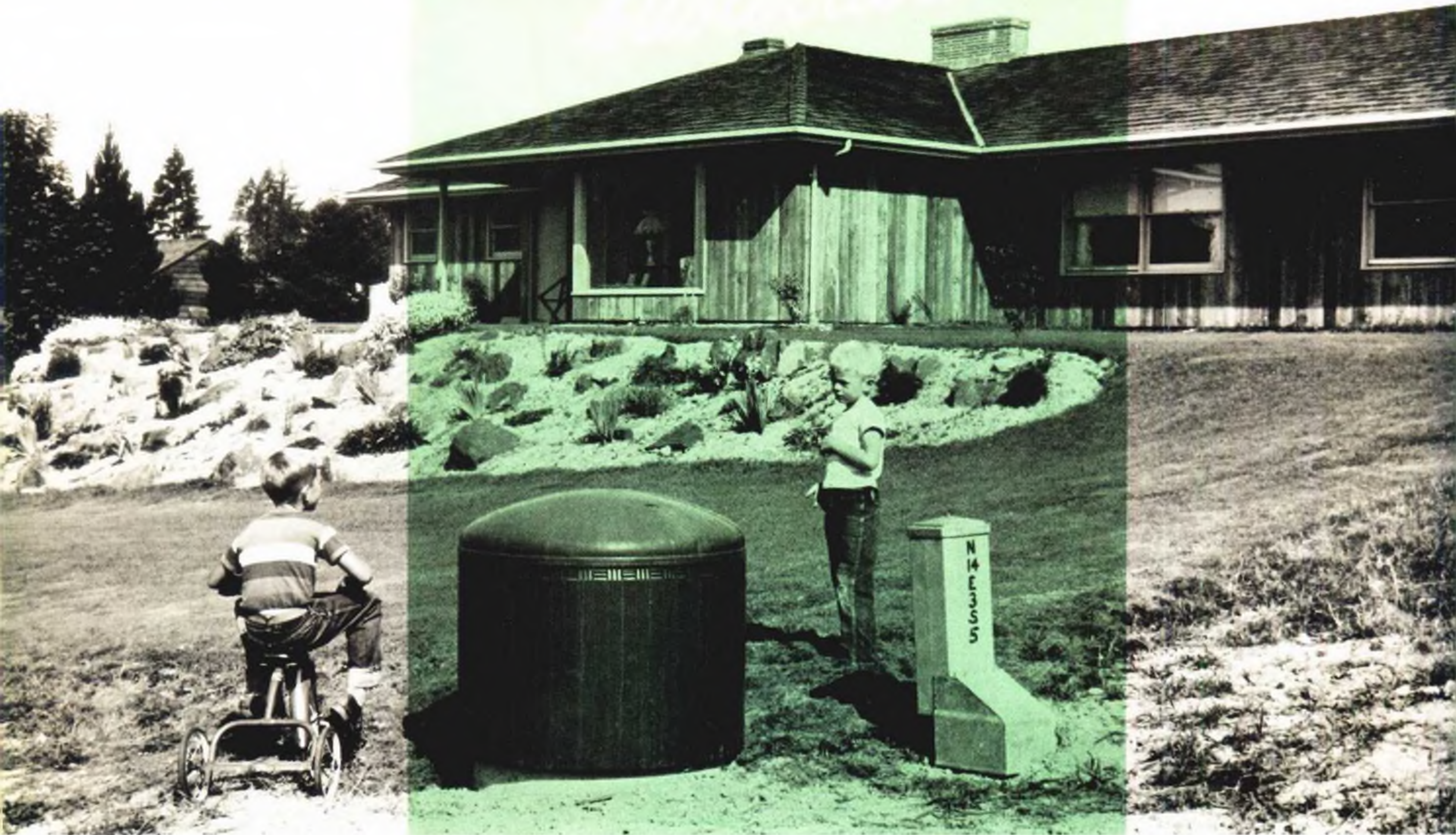
La caja del transformador ha sido provista de medidas especiales para evitar cualquier peligro a los niños o personas ajenas al servicio.
